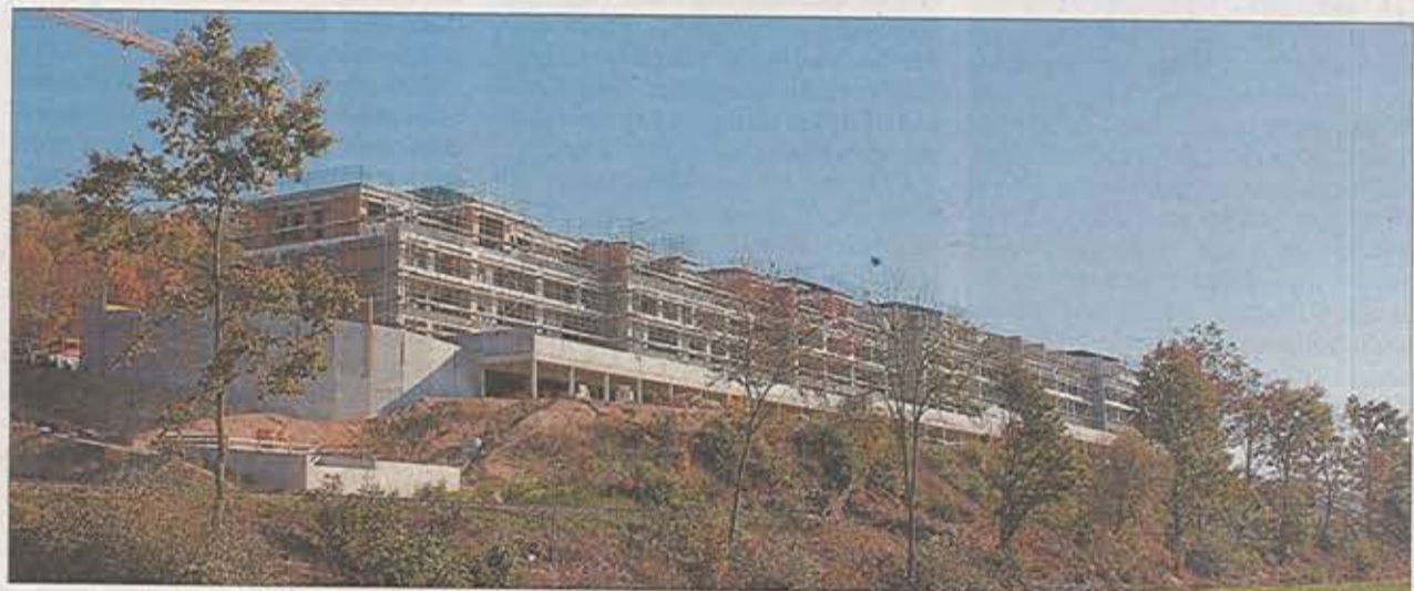
Der Rohbau ist schon fast fertig. Jetzt geht es an den Innenausbau.
