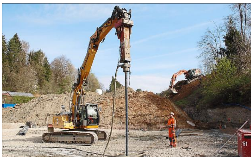
Eine Baufirma versenkt Gussrammpfähle in den Boden und verpresst sie mit dem Beton, um ihn tragfähiger zu machen. Fotos: Wolfgang Reimer
