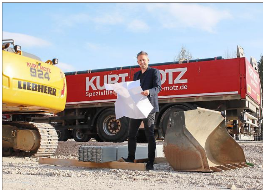
Es geht voran: Matthias Altmann mit den Plänen der Wohnanlage „Weißer Regen“.
