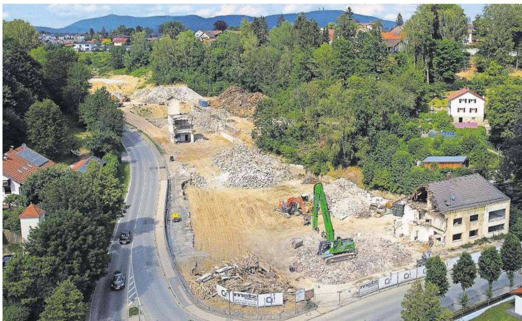
Das Areal der ehemaligen Stahlbaufirma Aschenbrenner zu Beginn der Woche: Fast alle Gebäude sind abgerissen. Am Dienstag wurde im Stadtrat die Bauleitplanung auf den Weg gebracht, um hier Platz für Märkte von Aldi, dm, Edeka und Tedi zu schaffen. FOTO: S. WEBER
