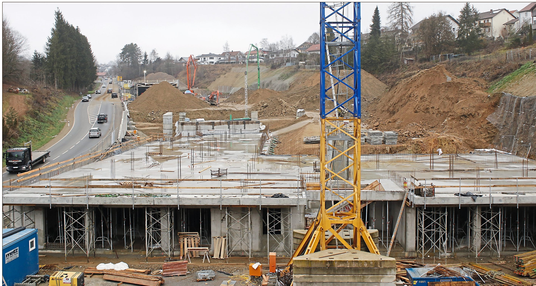
Im Vordergrund ist die Bodendecke des ersten Stockwerks des zukünftigen Edeka-Marktes zu sehen.
