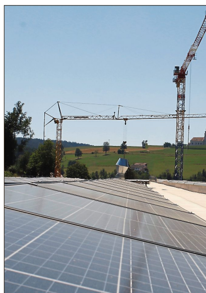
Auf drei Dächern werden mit der PV-Anlage jährlich rund 800 000 Kilowattstunden Strom produziert.
